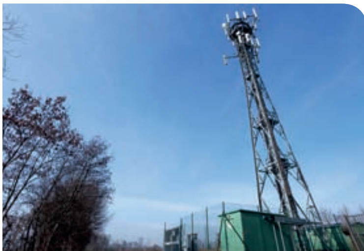
■ Le stazioni radio base (BTS – Base Transceiver Station) Vodafone dovevano essere protette da sabotaggi, furti e rischi naturali
