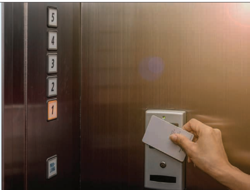
Fig. 4 - Nell'ambito di alcuni edifici gli ascensori e i montacarichi possono essere soggetti al riconoscimento automatico dell'utente e alla verifica dei diritti di accesso, sia per la chiamata al piano che per la selezione del piano di arrivo.
