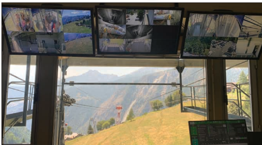
Monitor in sala pulpito per la gestione della videosorveglianza delle Stazioni della Funivia, del locale argani e delle due cabine - area passeggeri ed esterne
