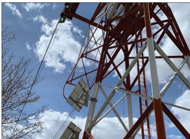
Sistema di alimentazione basato su storage solare
