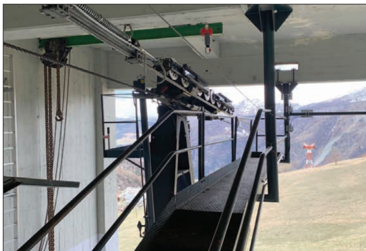
Stazione di Chamois: dispositivi wireless posizionati sulla passerella di manutenzione del carrello
