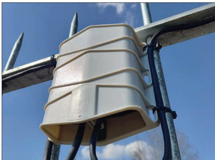
Recinzione sensibile allo scavalco SIOUX PRO2 + 3 radar a microonde Murena Plus sui varchi di accesso e sul tetto e barriera a microonda lineare Micro-Ray "a trappola" nel centro del deposito
